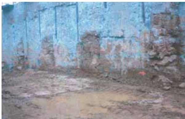
Photo 3 Paroi armée au coulis avec jambes de pantalon
